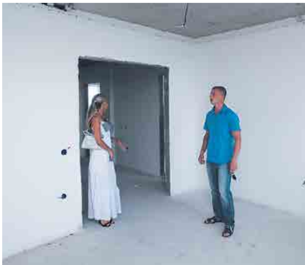
НЕПРАВИЛЬНАЯ ПЕРЕПЛАНИРОВКА НА ПЕРВЫХ ЭТАЖАХ МОЖЕТ НАНЕСТИ СЕРЬЕЗНЫЙ УЩЕРБ КОНСТРУКЦИИ ВСЕГО ДОМА, ГОВОРЯТ ЭКСПЕРТЫ. ФОТО ГЛЕБА ИЛЬИНСКОГО
